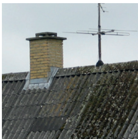
Ældre eternittage indeholder som oftest asbest.
