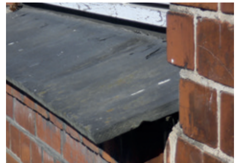
Sålbænk – kan indeholde asbest. Hvis der er usikkerhed om indholdet af asbest, skal materialerne håndteres, som om de indeholder asbest. Ved større mængder skal der foretages analyse.
