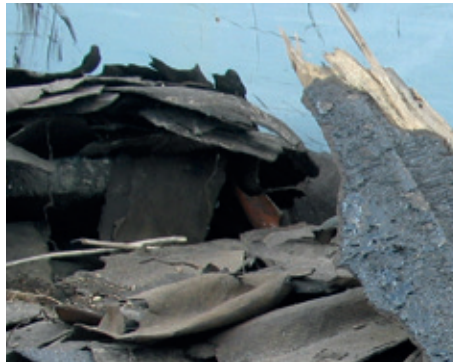
Ældre tagpap fra nedrivning. Ældre tagpap kan indeholde tjærestoffer. En stor del af tagpap fra nedrivning og renovering kan genbruges, såfremt det ikke indeholder tjærestoffer.
