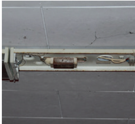
Ældre armaturer til lysstofrør indeholder ofte PCB.
