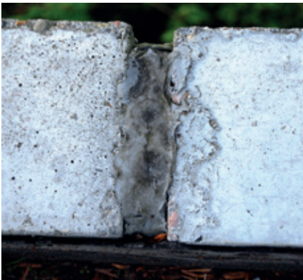
Betonelementer med PCB-holdig fuge i byggeri fra 60'erne.
