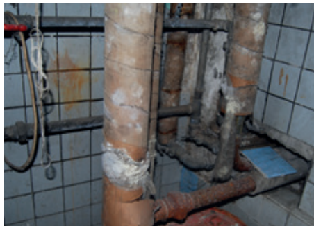
Rørisolering indeholdende asbest. Arbejdstilsynets regler skal følges ved asbestarbejde.
