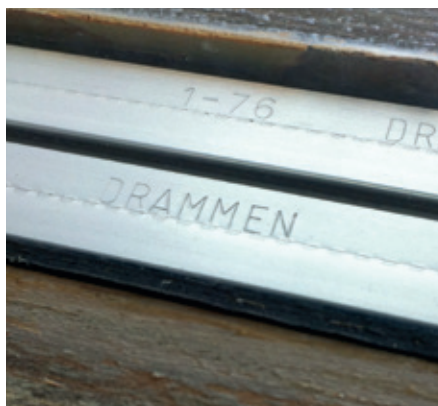
Prægningen i rudens afstandsliste viser, at ruden er fremstillet i januar 1976 (1-76). Ruden kan derfor indeholde PCB.
