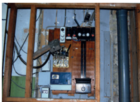
Eltavle kan indeholde relæer og andet elektrisk udstyr, der kan indeholde PCB og kviksløv.
