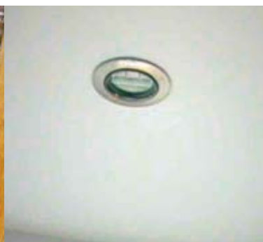
Elektrikeren har monteret halogenspot - har han udført arbejdet ordentligt?
