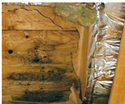
Utæthed i dampspærren giver risiko for fugtskader i konstruktionen.
